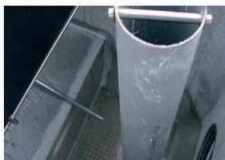
Dégrilleurs Avec piège à cailloux
