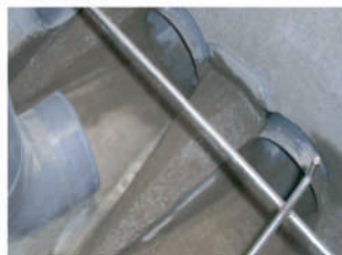
Dégrilleurs Avec dessableur
